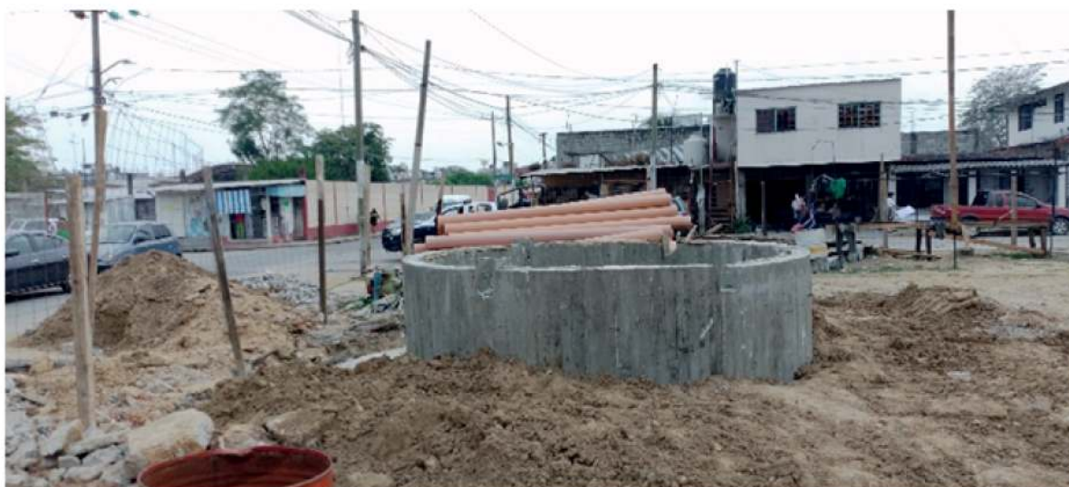
Fotografía: Cárcamo Pluvial en la calle Mariano Abasolo, esquina calle Antonio Santiago Ovando.
